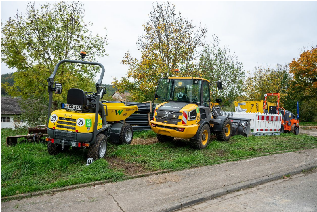
E-Maschinen und -Geräte sind maßgeblich für das Gelingen der „NETZbaustelle der Zukunft“. Foto: Rack Fotografie / Netze BW
